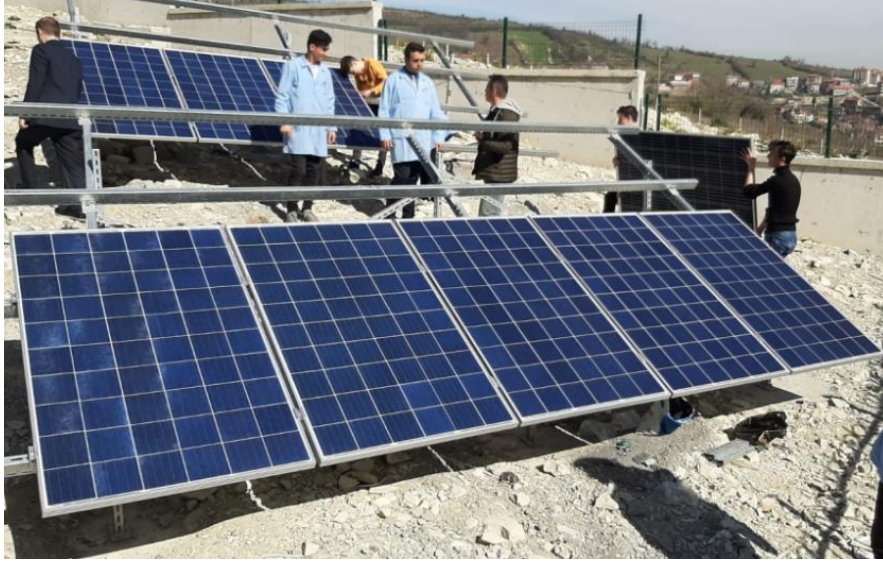
Resim 1: On Grid Fotovoltaik Uygulaması
